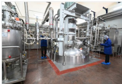
बायोकॉन लिमिटेड- बेंगलुरु प्लांट
